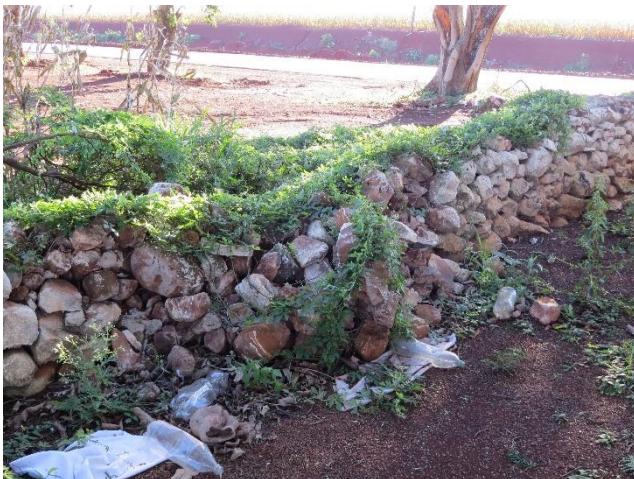
Figura 42: Trecho danificado na porção sudoeste.
