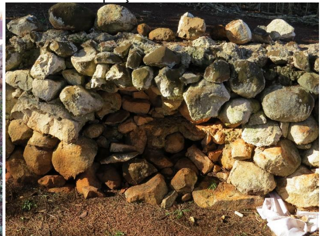
Figura 43: Parte do muro danificada na porção nordeste.
